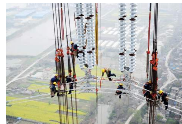
安徽铜陵—上海 1000 千伏“皖电东送”特高压输电工程是中国首条同塔双回路特高压交流输电工程，2013 年 9 月建成投运，每年输电能力达 500 亿千瓦时。图为施工人员在高空进行附件安装。
