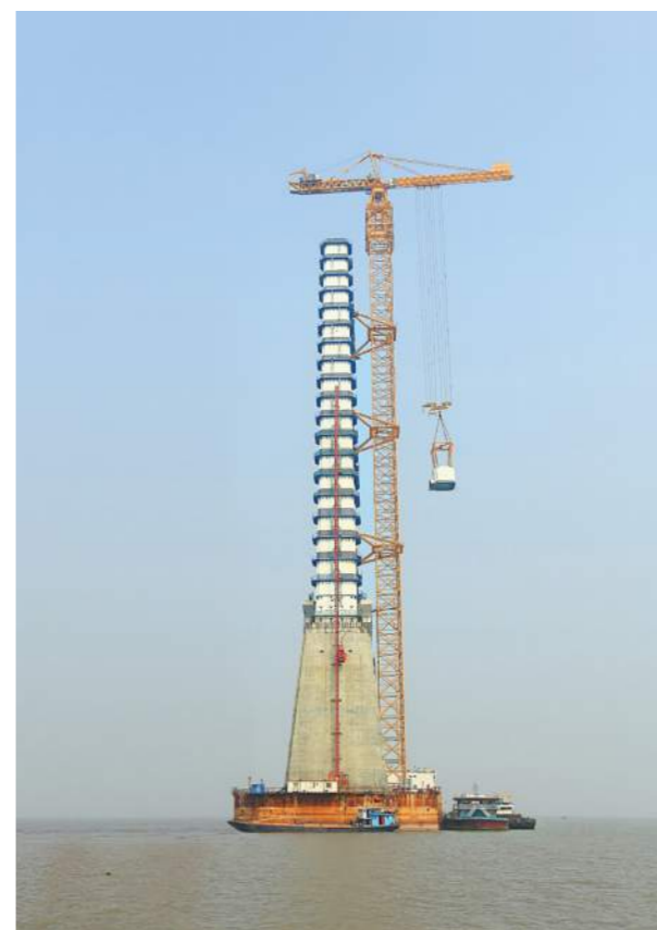
全球最大的上回转塔式起重机 D5200-240 在安徽马鞍山长江大桥施工中，创造了将 200 吨以上物件提升到 200 米以上高度的世界纪录，是世界首台实现“双两百”的起重机。
